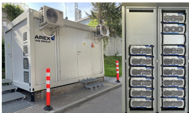
Rys. 1. Kontenerowa stacja przekształtnikowa PVT-01 (lewy) oraz główne przekształtniki w standardzie rack 19" (prawy)
